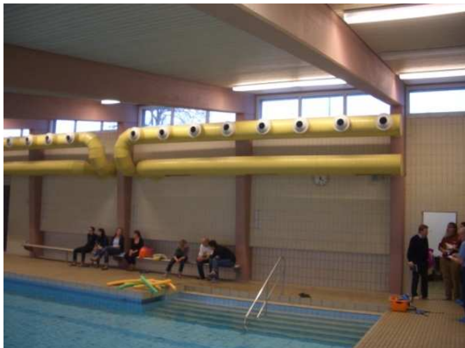
Luftverteilung in der Schwimmhalle
