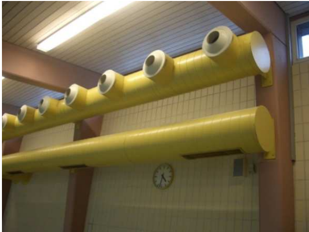
Zuluftrohr oben mit Weitwurfdüsen, Abluftrohr unten mit Abluftgitter in der Schwimmhalle
