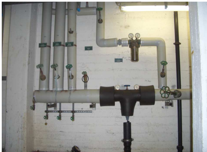
Kaltwasser-Hauptverteiler in Technikzentrale
