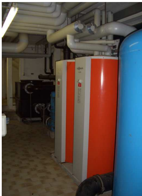
Trinkwarmwasserbereitung 2 x 350 Lit. Viessmann VertiCell
