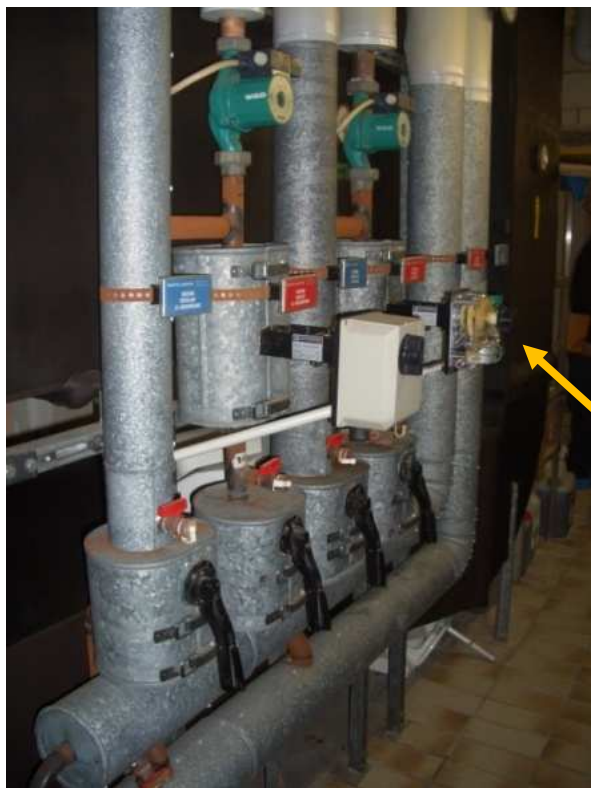
Heizkreispumpen für zwei Zonen bei dem GEA Lüftungsgerät
